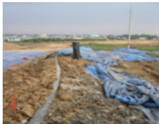
Hình 2. Hệ thống thu khí ở bãi chôn lấp Gò Cát
